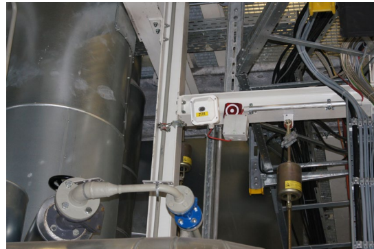
Abb. 34 Flammenmelder an einer Industrieanlage
