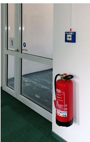
Abb. 49 Gut sichtbarer und leicht erreichbarer Feuerlöscher
