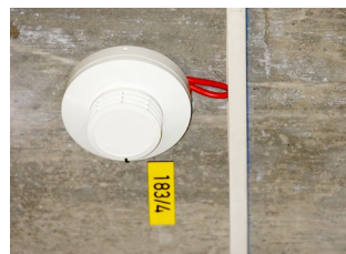
Abb. 33 Rauchmelder an einer Raumdecke
