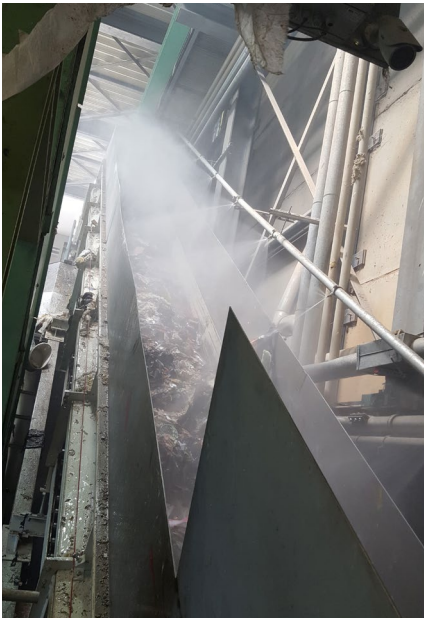
Abb. 60 Sprühwasserlöschanlage in Betrieb
